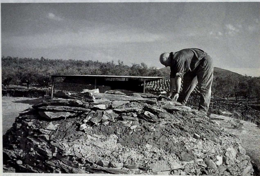
Foto 9. Cubierta de barro.
